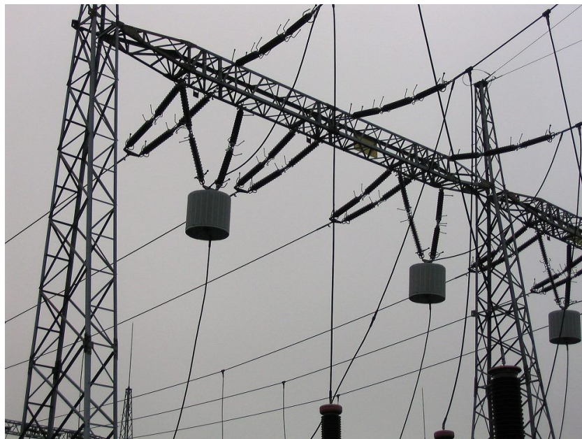
Dławiki zaporowe w stacji 220 kV
